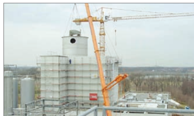
Trockner-Einhub bei Ammerland (2002)
